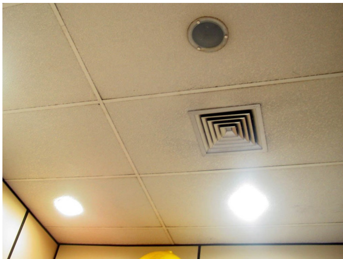
Figura 2 - Teto e iluminação aplicada na Sala de Terapia Ocupacional e Visual da AACD [Fotografia de FASA Fibra Ótica]
